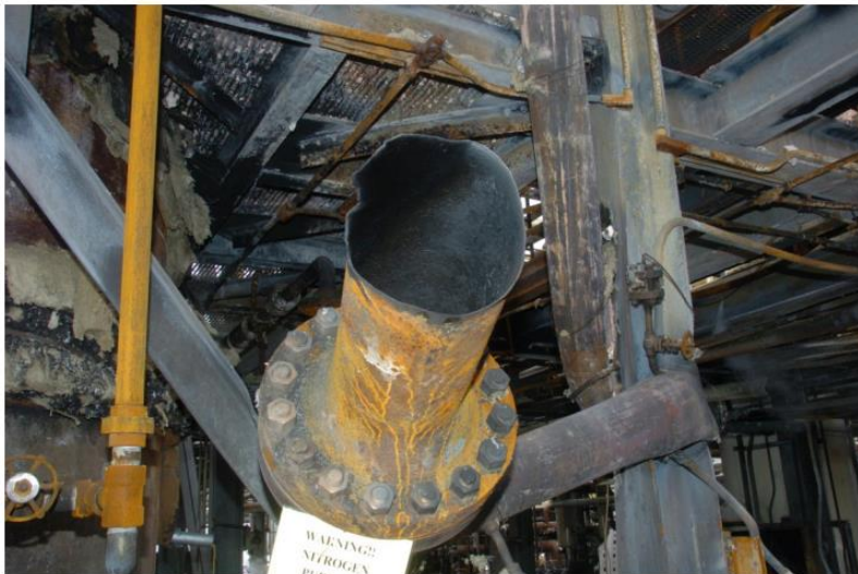
Obr. 4: Prasklý konec potrubí na ohnutém nosníku konstrukce
